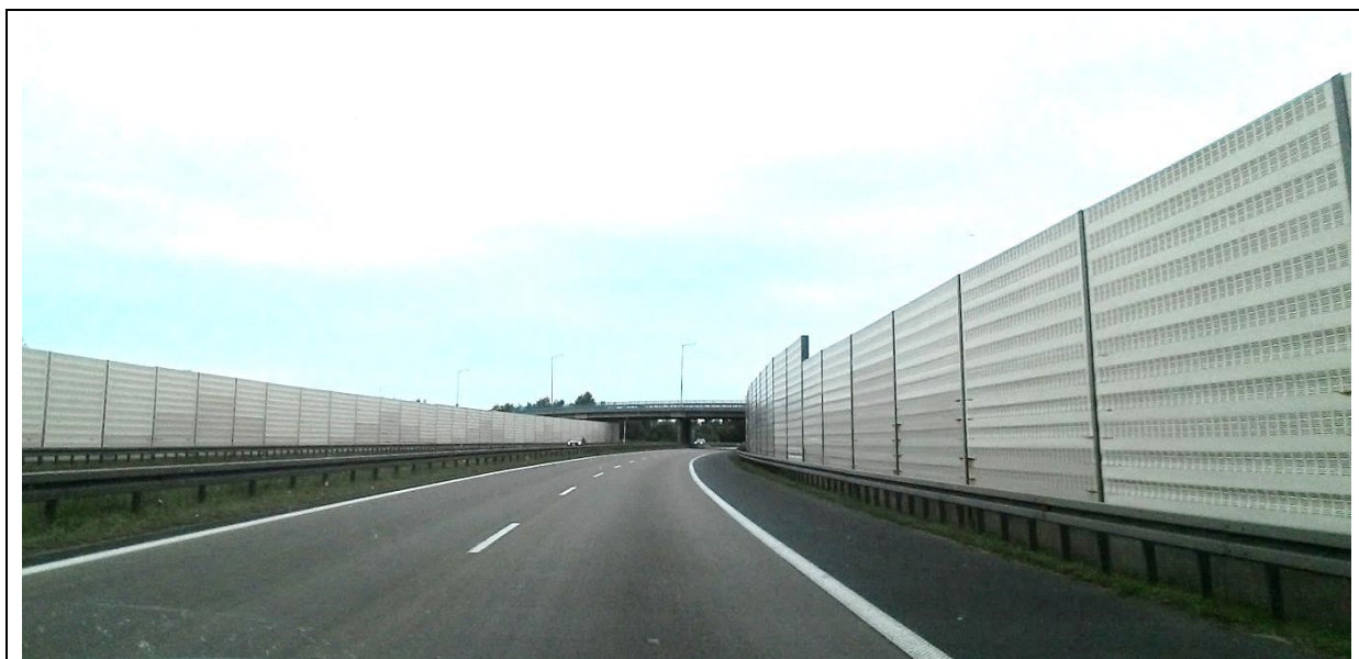
Rys. 42 Ekrany przeciwhałasowe pochłaniające zbudowane z kasetonów (materiały własne)
