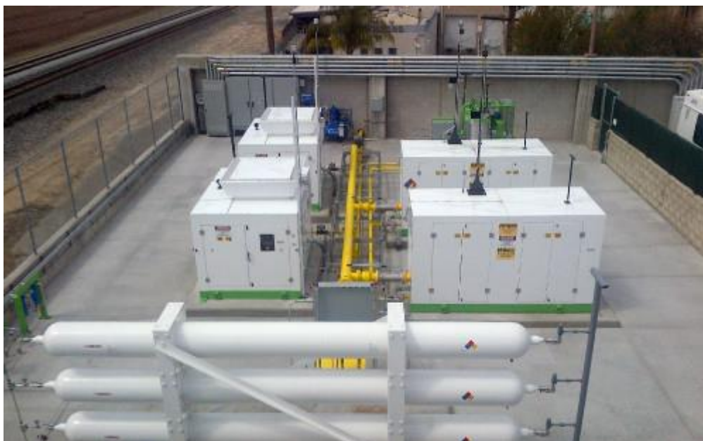
Rysunek 18 Kompresory oraz magazyny buforowe stacji CNG, źródło: http://cngcenter.com/services/cng-station-installation/cngfillstation/
