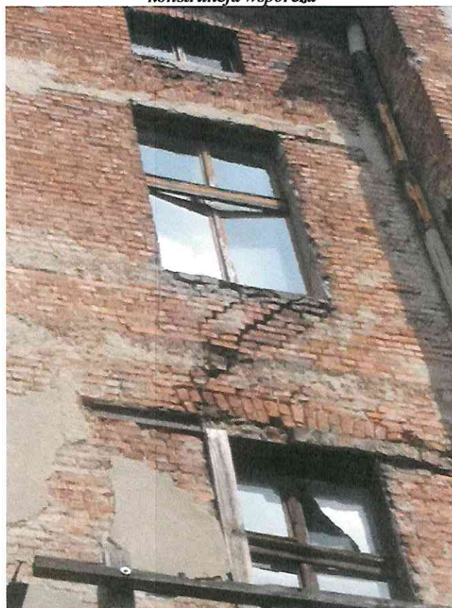
Zdj. 18. Elewacja zachodnia (od strony podwórza), uszkodzenie pasa międzyokiennego, uszkodzenia nadproży, stolarki okiennej, ubytki tynków i cegieł
