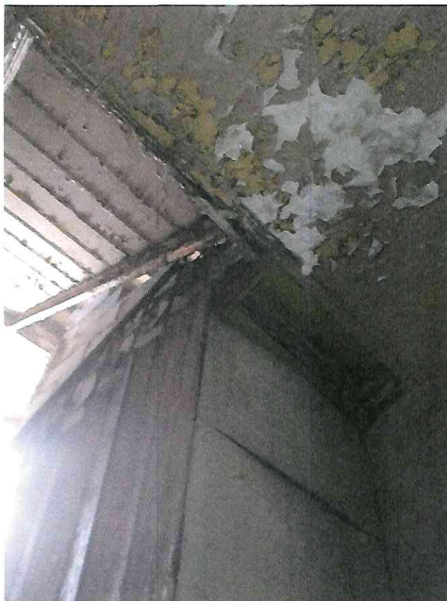
Zdj. 25. Klatka schodowa – stan zachowania
