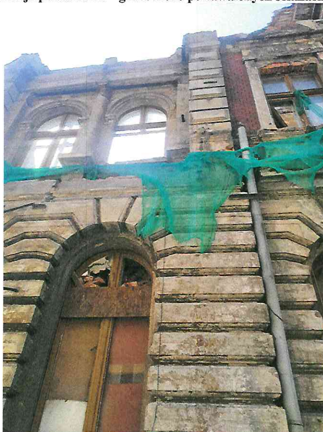
Zdj. 4. Elewacja wschodnia (frontowa) – zniszczenia stolarki okiennej, zawalona część ściany, stropy oraz dach
