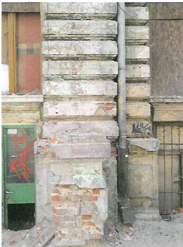
Zdj. 5. Elewacja wschodnia (frontowa) – stan zachowania, ubytki tynków, cegieł
