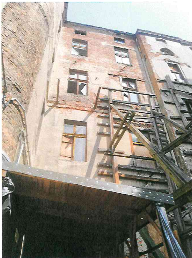
Zdj. 17. Elewacja zachodnia (od strony podwórza), zarysowania, ubytki tynków, cegieł, drewniana konstrukcja wsporcza
