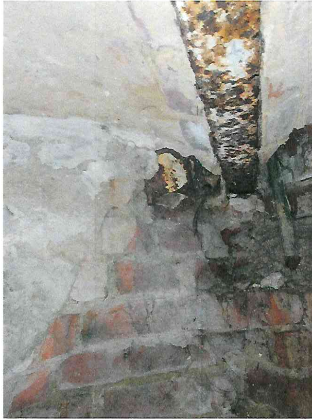
Zdj. 23. Ubytki tynków oraz cegieł, zawilgocenie ściany, korozja stalowych belek stropowych piwnicy
