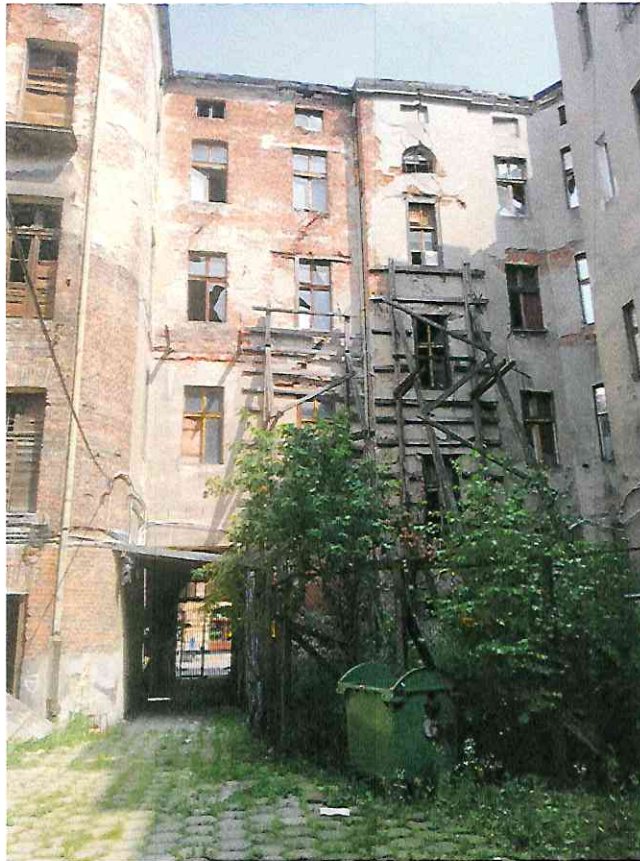
Zdj. 13. Elewacja zachodnia (od strony podwórza) – stan zachowania
