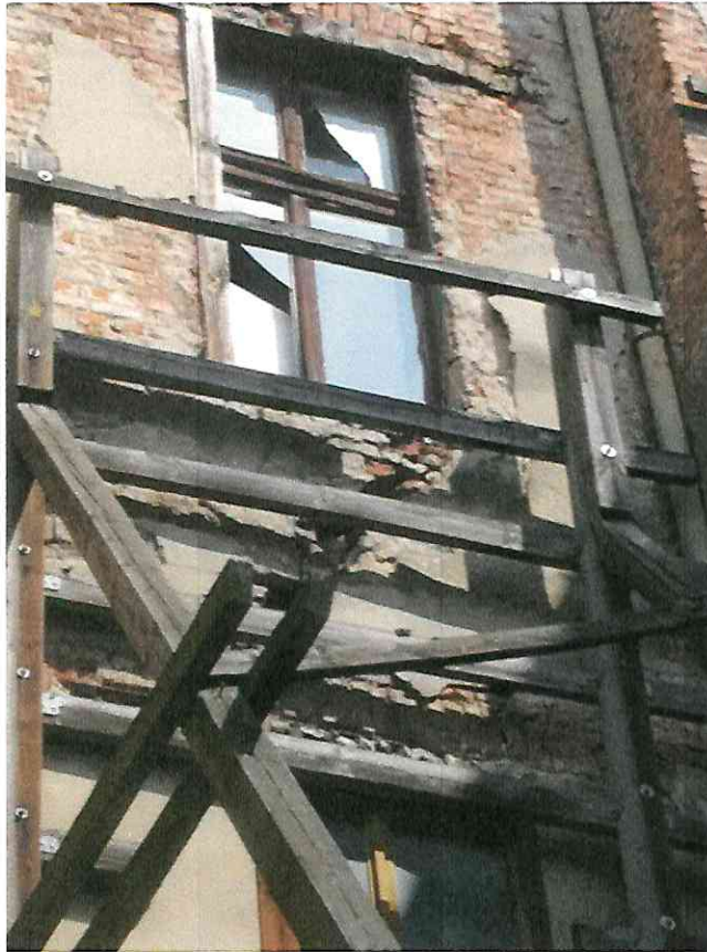
Zdj. 19. Elewacja zachodnia (od strony podwórza), uszkodzenie pasa międzyokiennego, uszkodzenia nadproży, stolarki okiennej, ubytki tynków i cegieł
