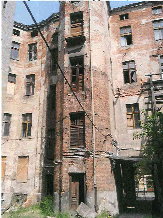
Zdj. 14. Elewacja zachodnia (od strony podwórza) – stan zachowania
