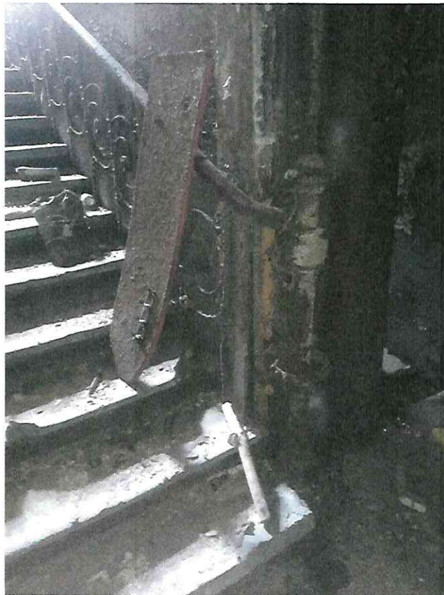
Zdj. 24. Klatka schodowa – stan zachowania
