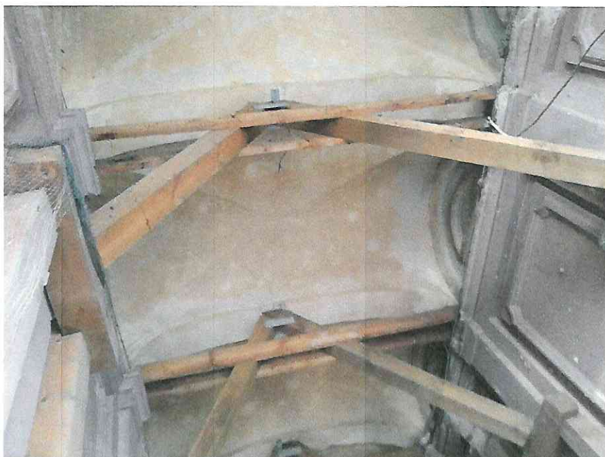
Zdj. 10. Strop nad przejazdem – zarysowania sklepień krzyżowych, drewniana konstrukcja wsporcza
