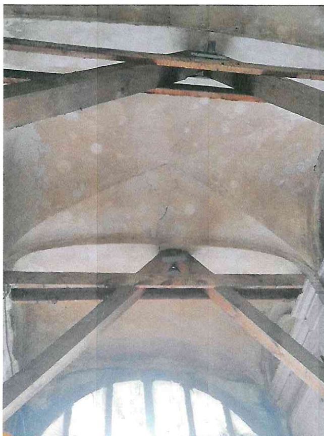
Zdj. 12. Strop nad przejazdem – zarysowania sklepień krzyżowych, drewniana konstrukcja wsporcza
