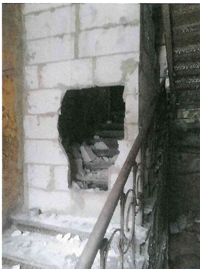
Zdj. 26. Klatka schodowa – stan zachowania
