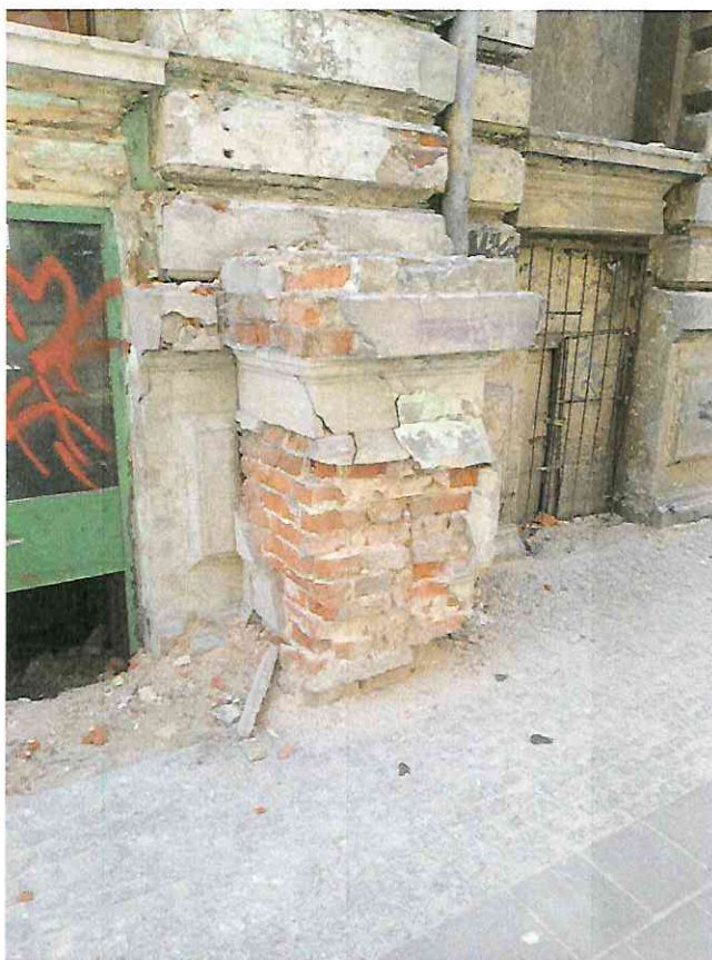
Zdj. 6. Elewacja wschodnia (frontowa) – stan zachowania, ubytki tynków, cegieł
