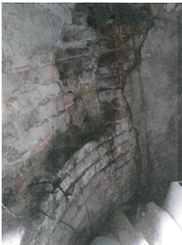
Zdj. 22. Uszkodzenie ściany i schodów przy zejściu do piwnicy
