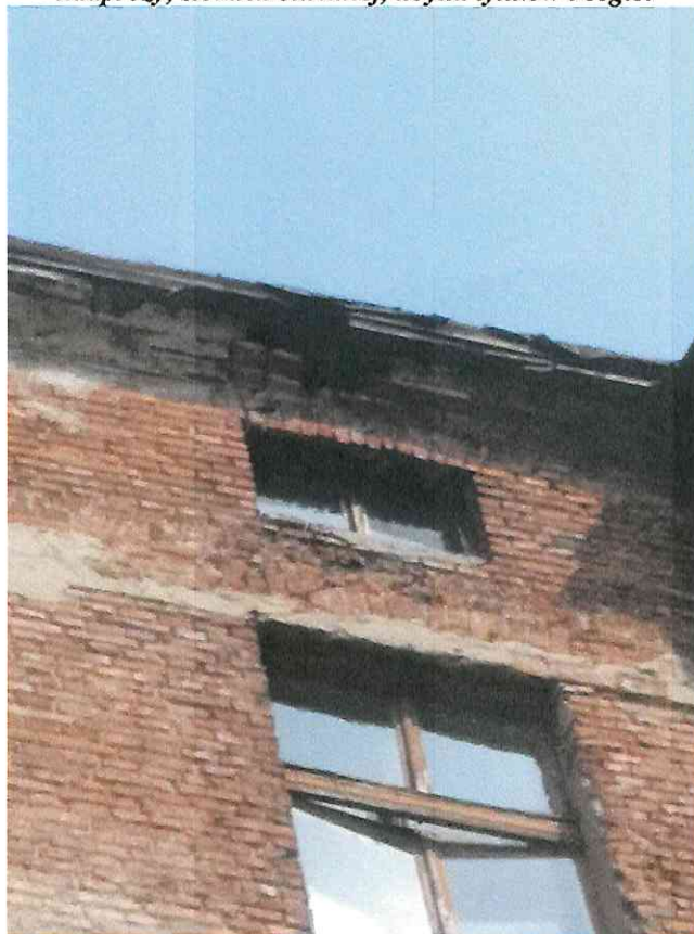
Zdj. 20. Elewacja zachodnia (od strony podwórza), zarysowanie muru, uszkodzenie pasa międzyokiennego, ubytki tynków i cegieł, uszkodzenie gzymsu okapowego
