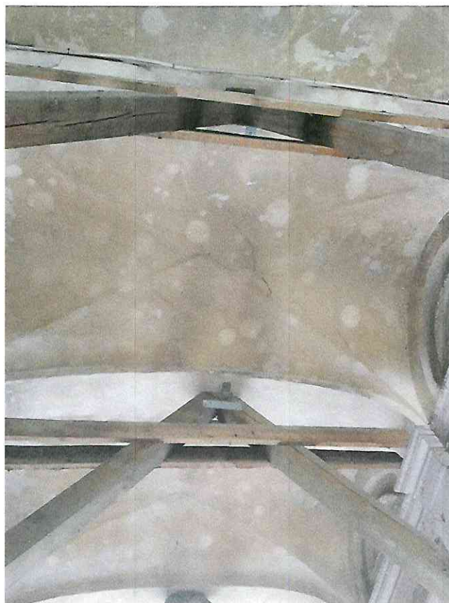
Zdj. 11. Strop nad przejazdem – zarysowania sklepień krzyżowych, drewniana konstrukcja wsporcza
