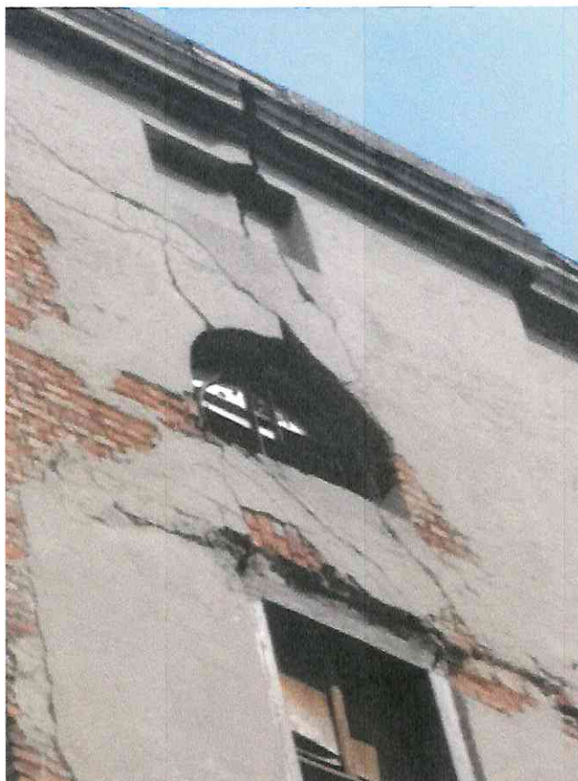
Zdj. 21. Elewacja zachodnia (od strony podwórza), zarysowanie muru, uszkodzenie pasa międzyokiennego oraz nadproży, ubytki tynków i cegieł, uszkodzenie gzymsu okapowego
