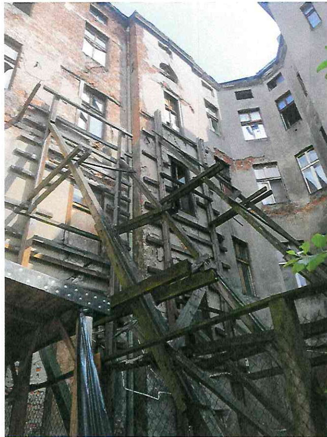
Zdj. 16. Elewacja zachodnia (od strony podwórza), zarysowania, ubytki tynków, cegieł, konstrukcja wsporcza
