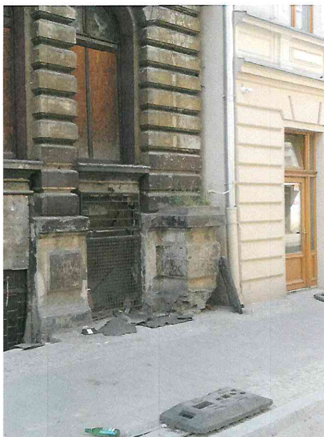
Zdj. 7. Elewacja wschodnia (frontowa) – stan zachowania, ubytki tynków, cegieł
