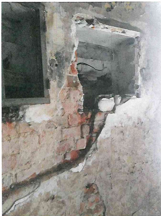
Zdj. 29. Ściana wewnętrzna, parter, stan zachowania
