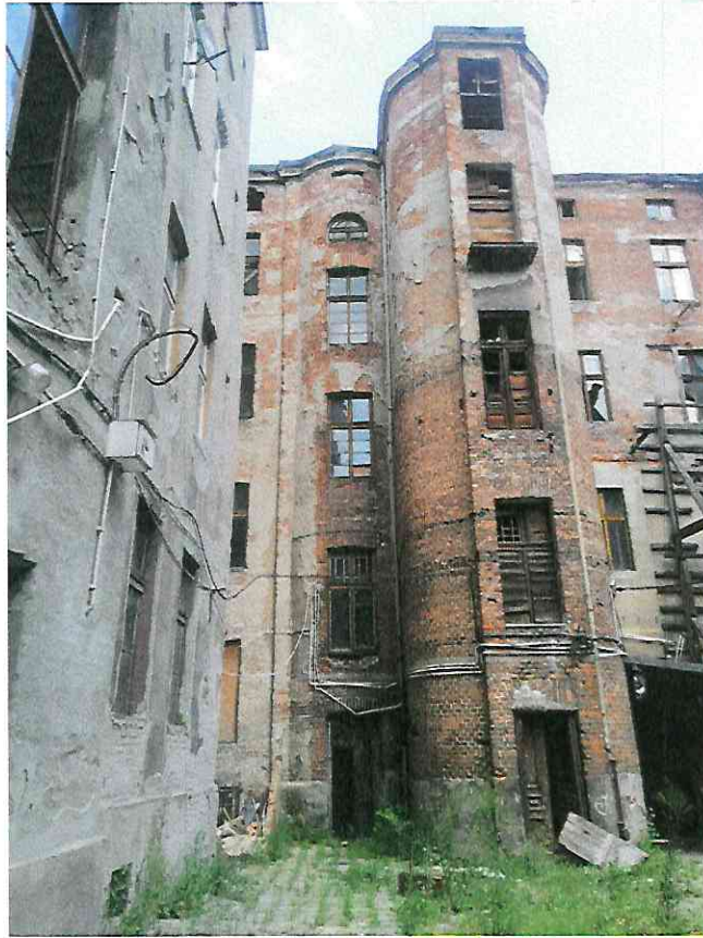
Zdj. 15. Elewacja zachodnia (od strony podwórza) – stan zachowania
