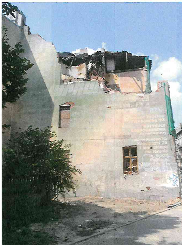
Zdj. 1. Elewacja południowa – zawalony dach, stropy, część ściany szczytowej oraz frontowej
