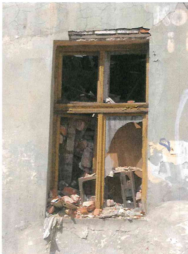
Zdj. 3. Okno, elewacja południowa – gruzowisko po zawalonych ścianach, stropach i dachu
