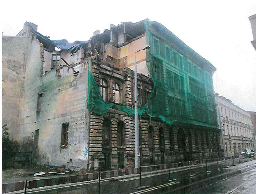
Zdj. 2. Elewacja wschodnia (frontowa) – zawalony dach, stropy, część ściany szczytowej oraz frontowej
