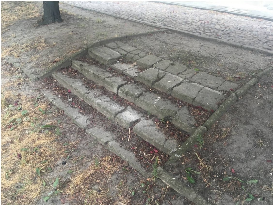
Fotografia 7 – 17.07.2019r. fot. B.Andrzejczak; Schody w złym stanie technicznym, ul. Daniłowskiego 7
