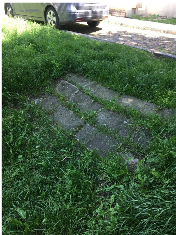
Fotografia 6 – 19.02.2019r. fot. B.Andrzejczak; Schody w złym stanie technicznym, ul. Perla
