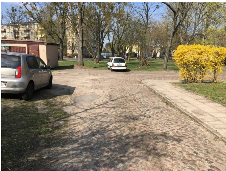
Fotografia 1 – 08.04.2019r., fot. B.Andrzejczak; Wewnętrzna brukowana uliczka – braki w obrzeżach, ul. Srebrzyńska 99.
