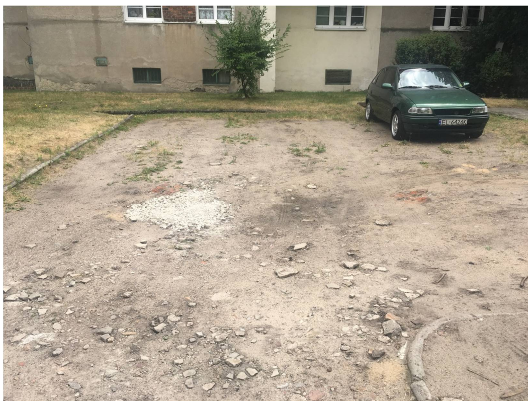
Fotografia 34– 17.07.2019r., fot. B.Andrzejczak, Skwer od strony południowej z nawierzchnią z tłucznia (w złym stanie technicznym), ul. Srebrzyńska 87.
