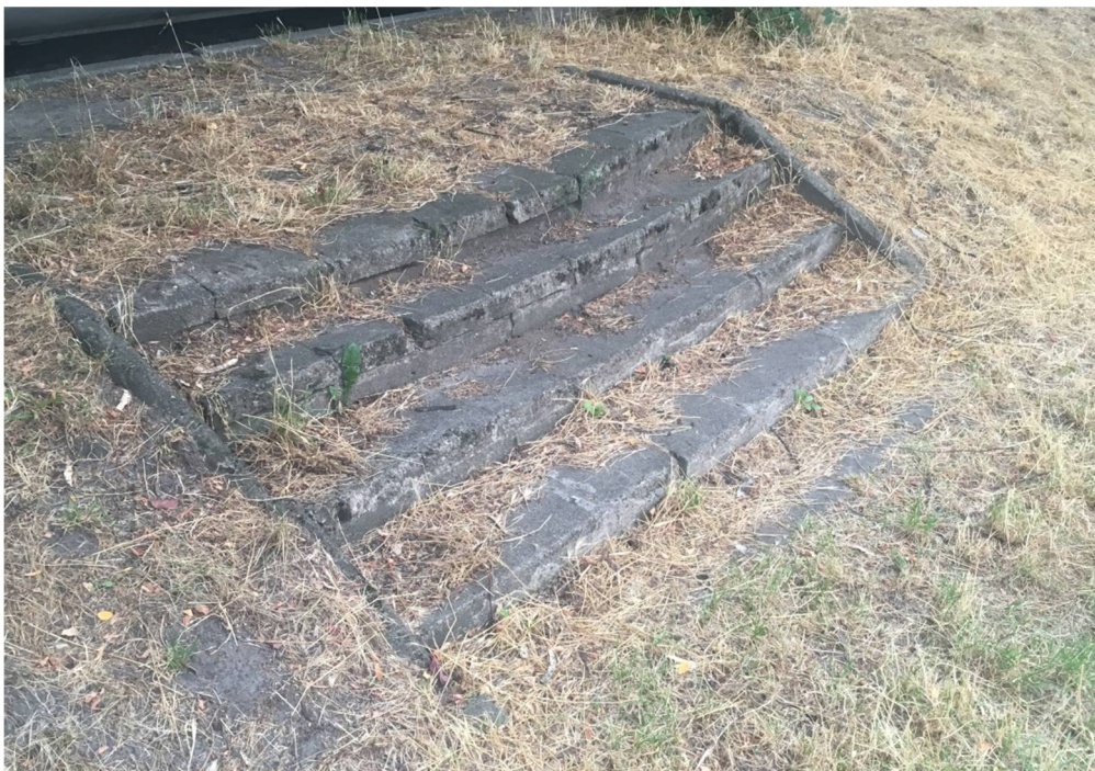
Fotografia 8– 17.07.2019r. fot. B.Andrzejczak; Schody (w złym stanie technicznym) prowadzące na skwer z trzepakami, ul. Daniłowskiego 7
